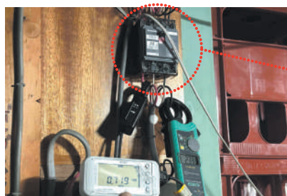
洗瓶機ポンプ ブレーカー
