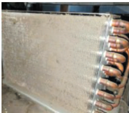
● 洗浄を提案された熱交換器
